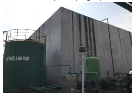
Bể chứa nước sau xử lý
