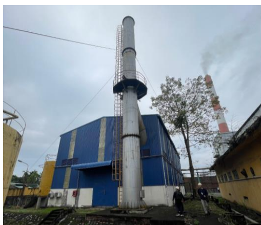
Hình 1.5. Hình ảnh lò hơi phụ
