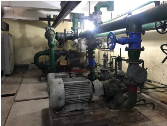
Hình 1.9. Trạm bơm nước ngọt sông Uông
