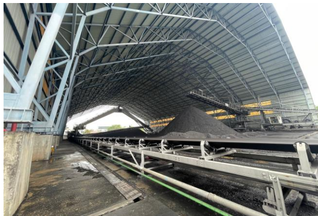
Hình 3.2. rãnh thoát nước mưa kho than tổ máy 300MW
