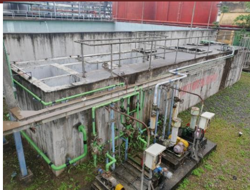
Hình 3.16. Hệ thống xử lý nước thải sinh hoạt tổ máy 300MW
