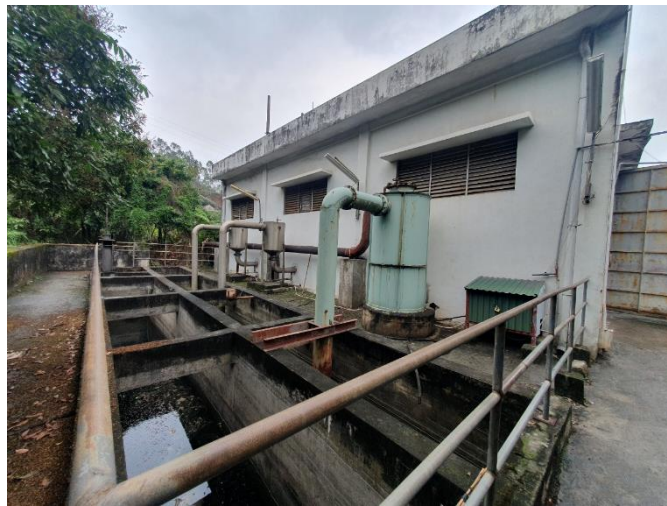
Hình 3.11. Trạm bơm nước ngược từ hồ lắng Hồ xỉ về nhà máy
