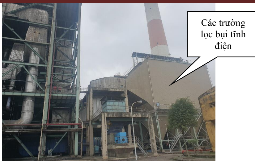
Hình 3.31. Hệ thống lọc bụi tĩnh điện tổ máy
