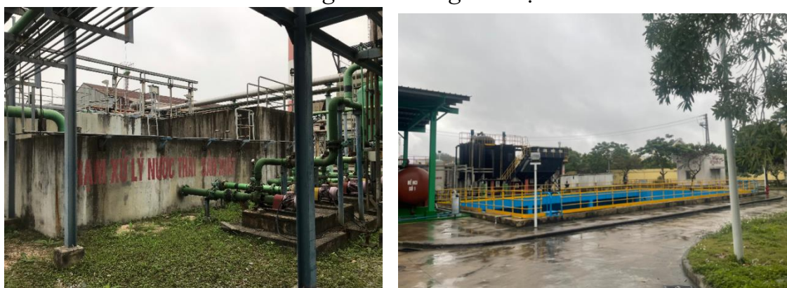
Hình 3.23. Trạm xử lý nước thải công nghiệp của 02 tổ máy
