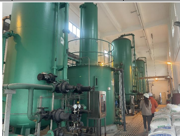
Hệ thống bình khử khí
