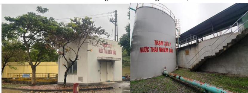
Hình 3.21. Trạm xử lý nước thải nhiễm dầu của 02 tổ máy
